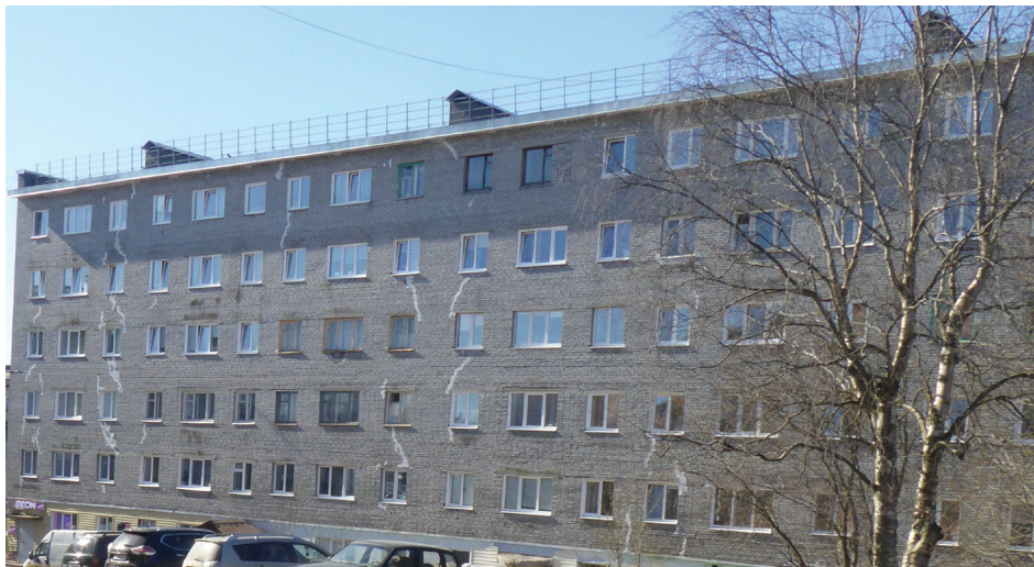
Рис. 4. Дом № 8 на ул. Фестивальная. Старые трещины замазаны белой штукатуркой Fig. 4. Building No. 8 on Festivalnaya Street. Old cracks have been covered with white plaster
