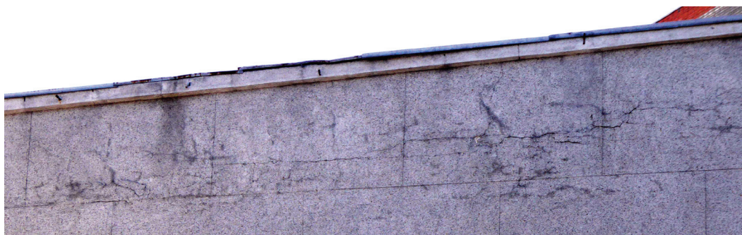
Рис. 6. Тектоническое расслоение верхней части несущей боковой стены кинотеатра «Полярный» Fig. 6. Tectonic layering of the upper part of the load-bearing side wall of the «Polarniy» cinema
