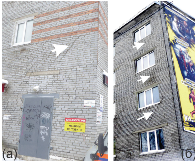
Рис. 3. Дом на ул. Ферсмана 7 (а) и Северная 27 А (б). Трещины секут их под углом \approx 45^\circ Fig. 3. Houses on Fersman Street 7 (a) and Severnaya 27 A (b). Cracks cut them at an angle of \approx 45^\circ
