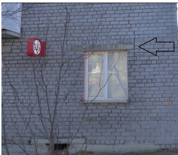
Рис. 7. Девятиэтажный дом № 4 «а», ул. Фестивальная. Трещина между окнами 1-го и 2-го этажей Fig. 7. Nine-story building No. 4a, Festivalnaya Street. Crack between the windows of the first and second floors
