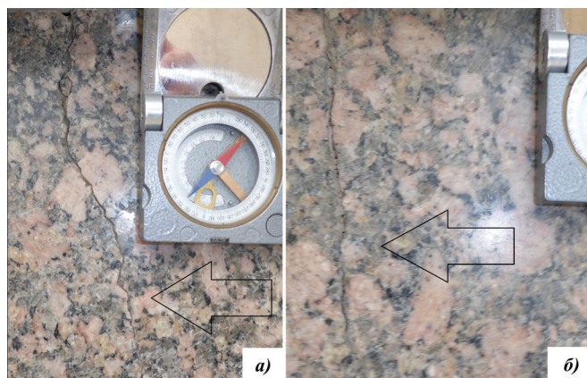
Рис.2. Трещины отрыва в вестибюле Главного здания ФИЦ: внутри а) слева, б) справа
